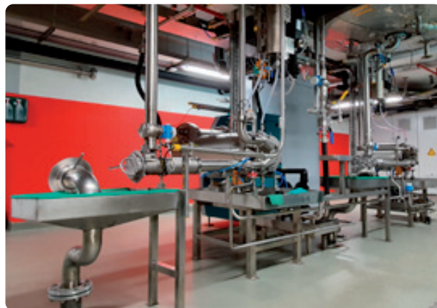
De installatie, gemonteerd en in gebruik genomen.
