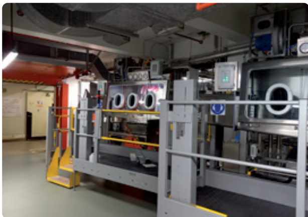
De handschoenkasten waarin het pigment vanuit zakken wordt gestort om aan de vloeistofstroom toegevoegd te worden (bevochtigingsproces).
