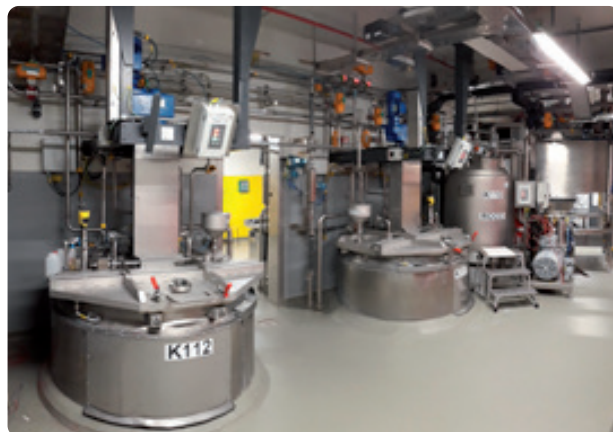
De gerecupereerde ketels waarin nu de inkt wordt bereid.
